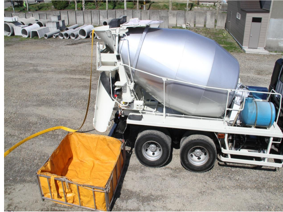
②供給した水を簡易水槽へ給水する様子
